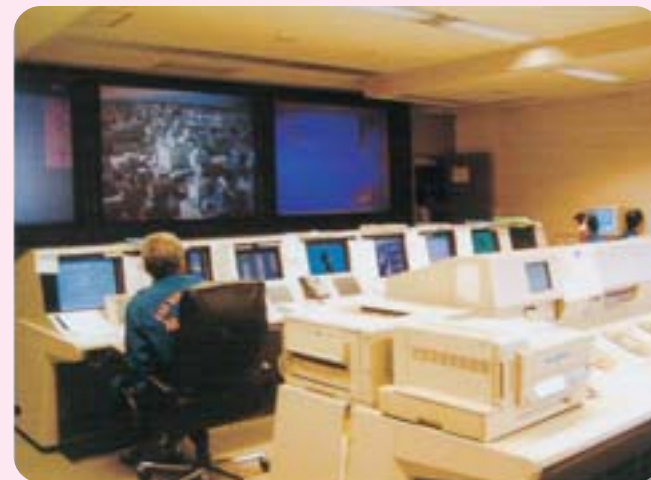
消防本部の指令室
